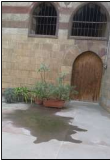
شكل (18) يوضح الإهمال الغير متعمد عن طريق زيادة مياه ري أحواض الزرع مما يؤدي لتسربه للأرضيات الحجرية والتي أدت لتكوين طحالب في الأرضية نتيجة لذلك للإهمال الغير متعمد
